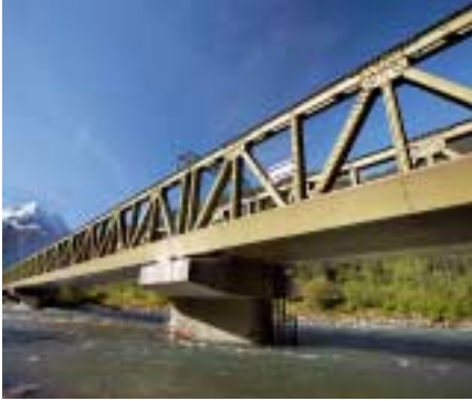
Für die Zubringerstrecken von Erstfeld zur Neat-Baustelle Amsteg fanden zwei Kriegsbrücken eine neue Verwendung. (AS)
